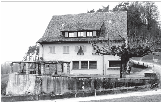
Das prächtig gelegene Berggasthaus vergammelt: Risse werden breiter, Mauern verrotten, Fassaden bröckeln.
